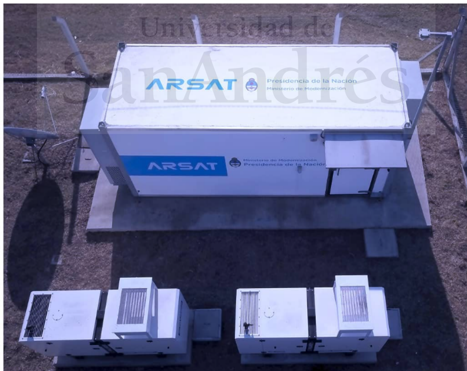
Imágen N° 4: Nodo de fibra óptica
