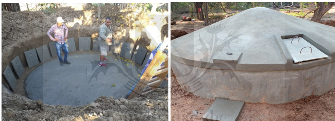
Fotografía 1 y 2: Cisterna de almacenamiento de Agua a construir con los fondos destinados a la causa Agua en cada comunidades del Norte Argentino que esté afectada por la problemática.
