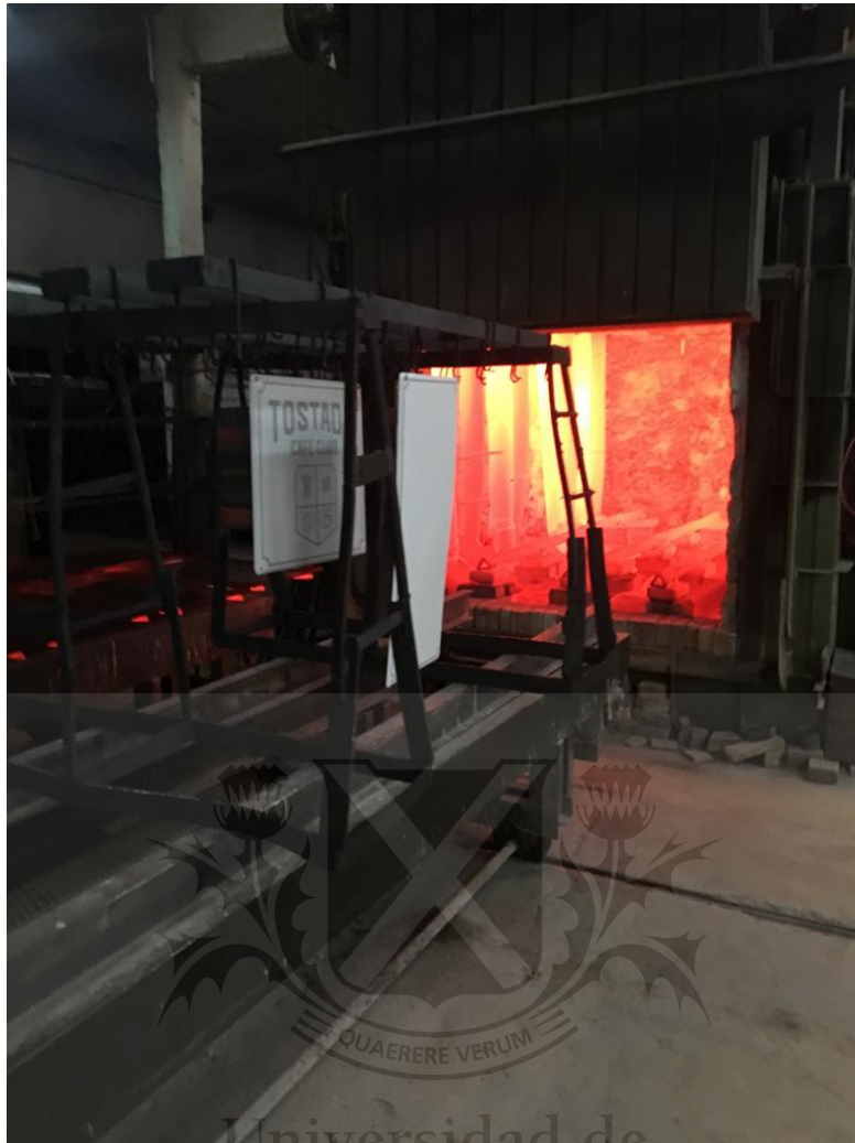
Horno industrial de la Fabrica Enlozados el mirador, estatico con cilindros a Gas. Capacidad 2 m3. Posee volante y riel de entrada.
