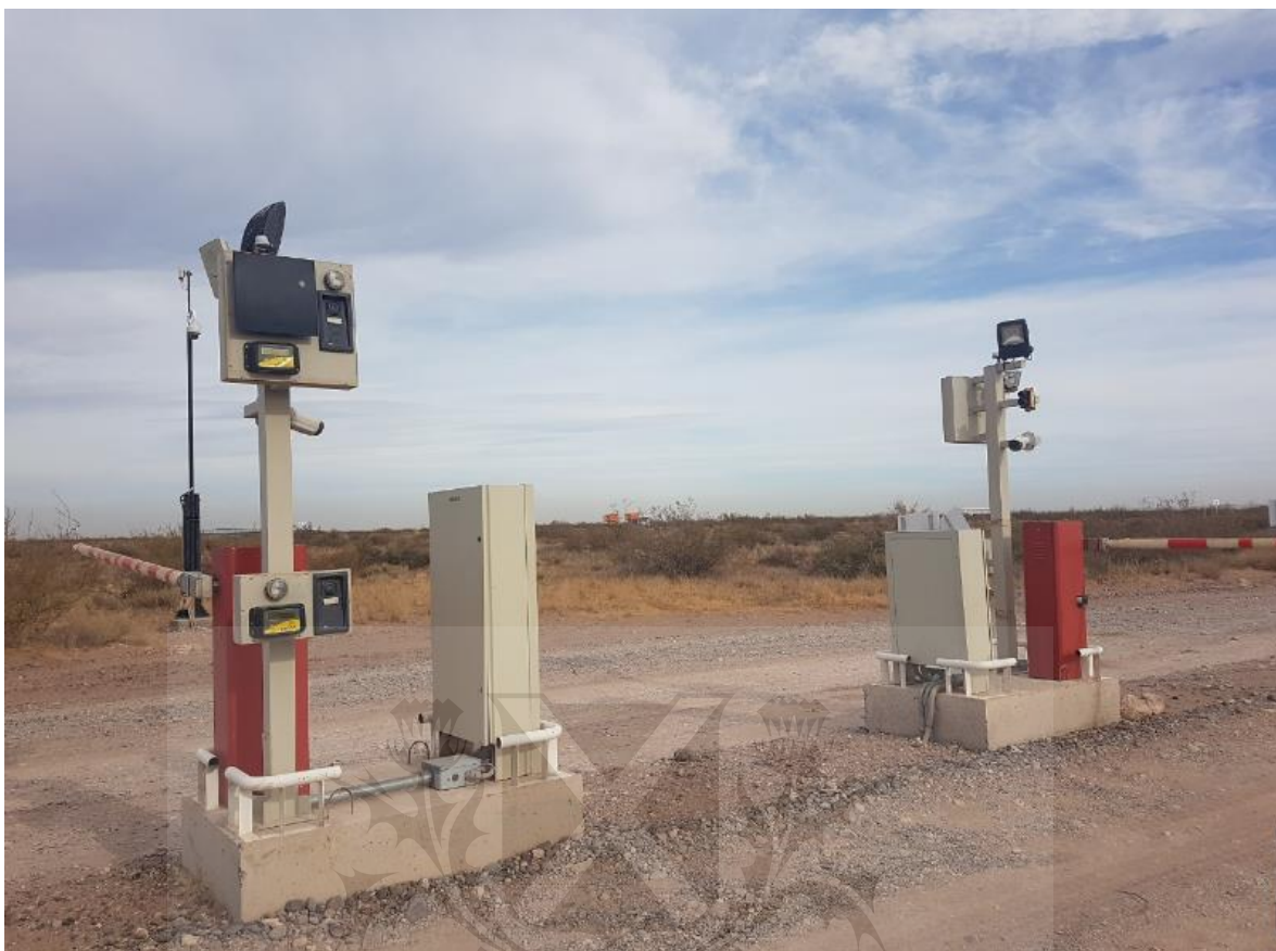
Control de Acceso Vehicular YPF. Proveedor: Prosegur.
