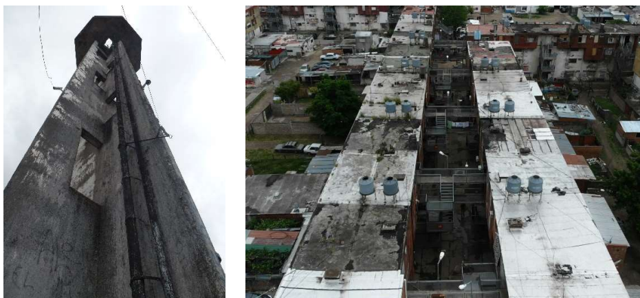
Imagen 28. Tanque general y tanques secundarios en azoteas de edificios del CHPS
