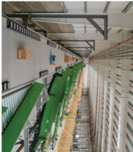
Marzo 2019 - Interior de la planta Via Automática
