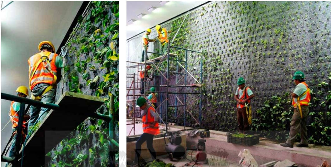
Fig. 7: Instalación de un jardín vertical del tipo hidropónico (fijación sobre capa textil) 26
