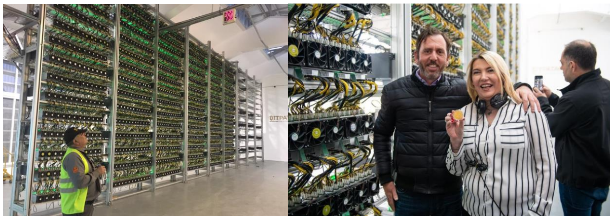
Izquierda: foto de unos de los racks de la planta. Derecha: Diego Pando (fundador de la empresa) con la gobernadora de Tierra del Fuego en 2018.
