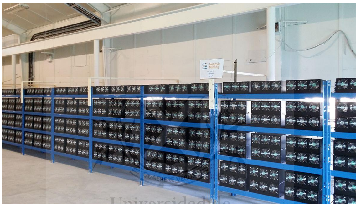
Interior de una minera convencional con racks y procesadores ASIC.
