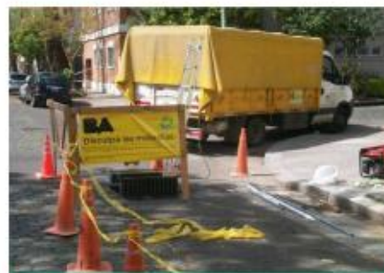
Instalación de sensores en desagües pluviales y conductos de agua.
