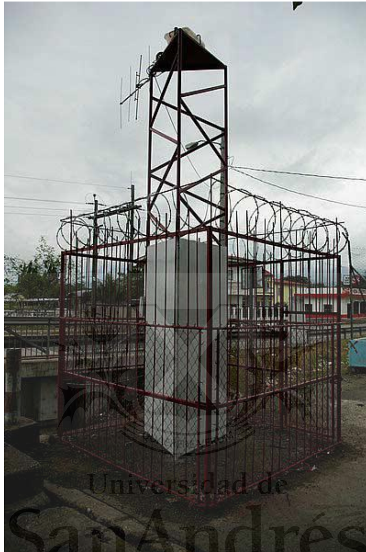
Figura 20. Antena de transmisión de información de sensores en altura. Protegida contra el vandalismo. Honduras.
