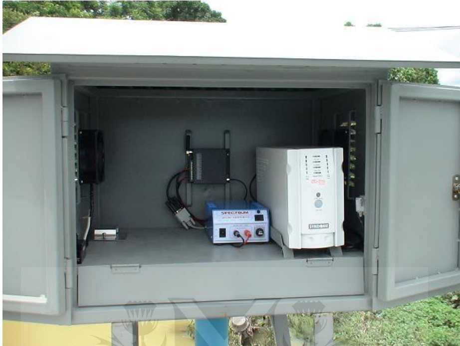
Figura 26. Foto del Gabinete instalado.
